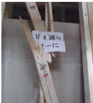
内部の筋かいが折れた (内部階段正面の筋かい)
